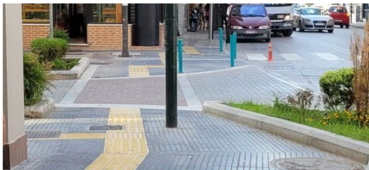
Εικόνα 66: Ράμπα επί της οδού Παναγούλη (μέτρια κατάσταση) - υψομετρική διαφορά μεταξύ κρασπέδου της ράμπας και του οδοστρώματος
