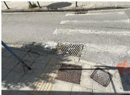
Εικόνα 190: Διάβαση επί της οδού Ζωοδόχου Πηγής (μέτρια κατάσταση) - έλλειψη ραμπών εξυπηρέτησης
