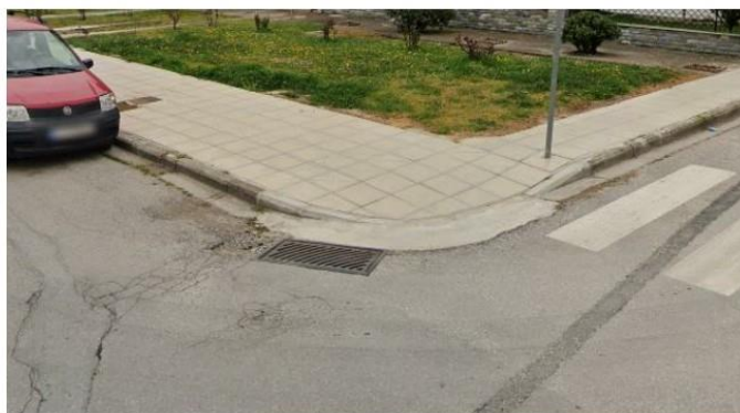
Εικόνα 407: Ράμπα επί της οδού Γαριτσίου (μέτρια κατάσταση) - μεγάλη κλίση
