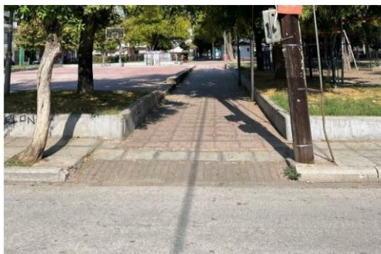
Εικόνα 528: Ράμπα επί της οδού Δημητριάδη με Εθν. Αντιστάσεως (κακή κατάσταση)
