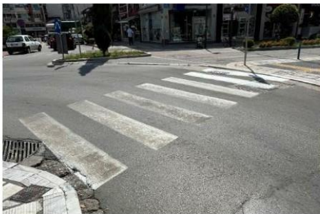
Εικόνα 230: Διάβαση επί της οδού Βενιζέλου σε διασταύρωση με Ολύμπου (καλή κατάσταση) - έλλειψη προσβάσιμης σήμανσης
