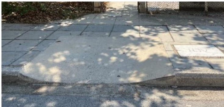
Εικόνα 622: Ράμπα επί της Βιδάλη (κακή κατάσταση) – απουσία οδηγού όδευσης τυφλών και χωρίς επίστρωση πλακών πεζοδρομίου
