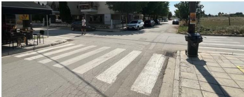
Εικόνα 709: Διάβαση επί της οδού Αυλώνος στην είσοδο του 26 ου ΔΣ (μέτρια κατάσταση) – έλλειψη ραμπών
