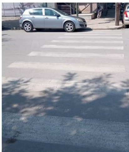
Εικόνα 672: Διάβαση επί της οδού Γιάγκου στη διασταύρωσή της με την οδό Χατζημιχάλη (κακή κατάσταση) – ξεθωριασμένη διαγράμμιση και φθαρμένο οδόστρωμα
