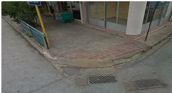
Εικόνα 837: Ράμπα στη συμβολή της οδού Μακεδονίας με την οδό Ελ. Βενιζέλου (μέτρια κατάσταση)
