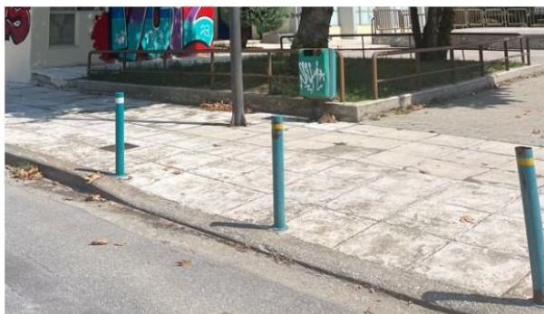
Εικόνα 713: Ράμπα στην οδό Νικολοπούλου (μέτρια κατάσταση) – μεγάλη κλίση και χωρίς οδηγό όδευσης
